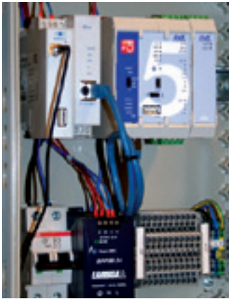
Kommunikationsbox mit Mobilfunkrouter.
